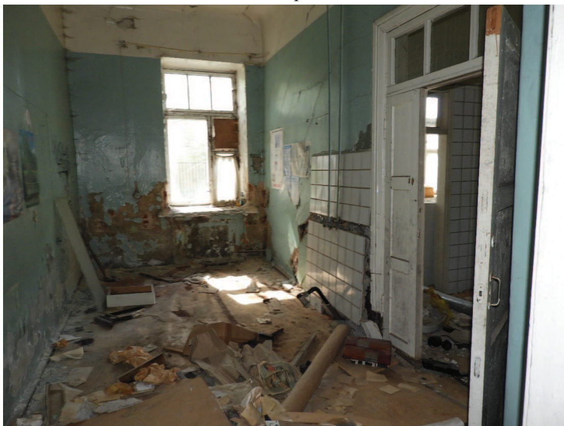
32. Интерьер. Западное помещение на первом этаже. Поперечные сквозные трещины.
