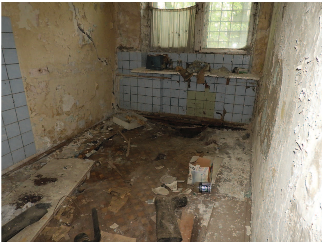
33. Интерьер. Западное помещение на первом этаже. Провалы в полу.
