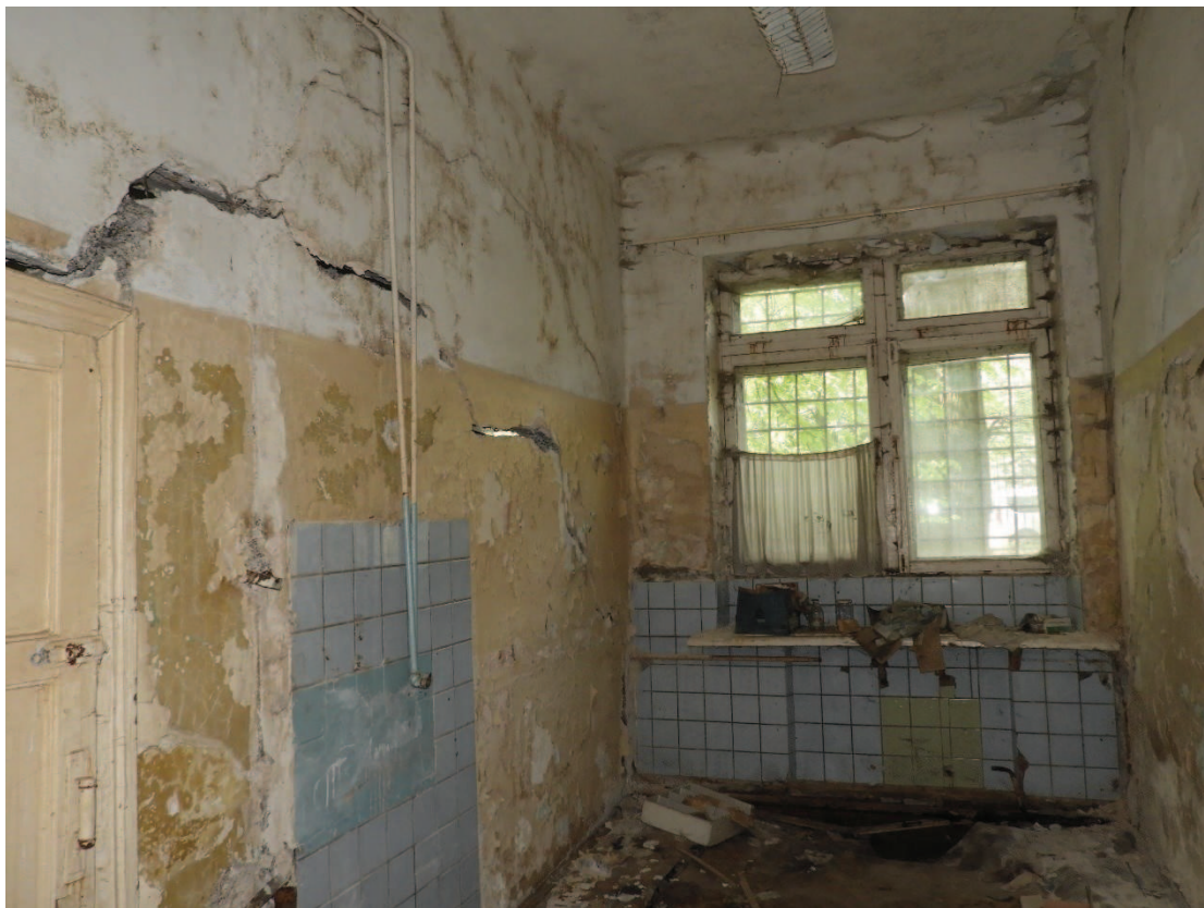
30. Интерьер. Западное помещение на первом этаже. Поперечные сквозные трещины.
