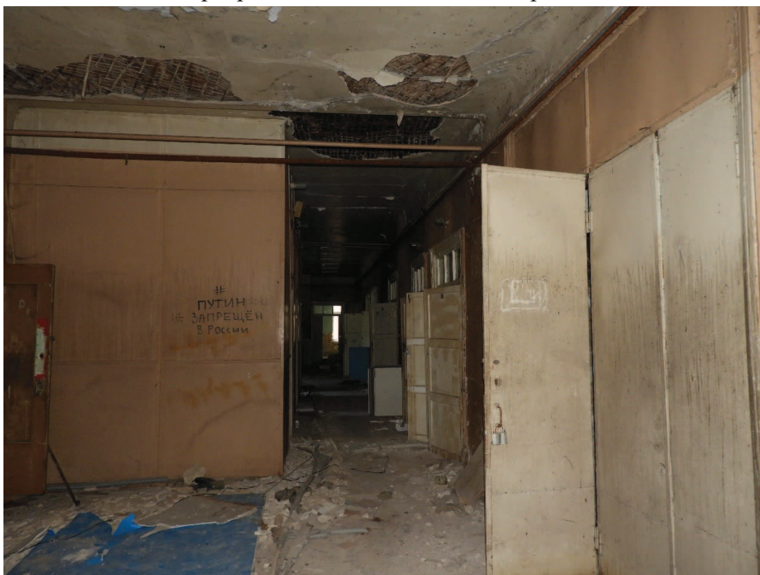
36. Интерьер. Коридор на первом этаже. Обвалы штукатурки.
