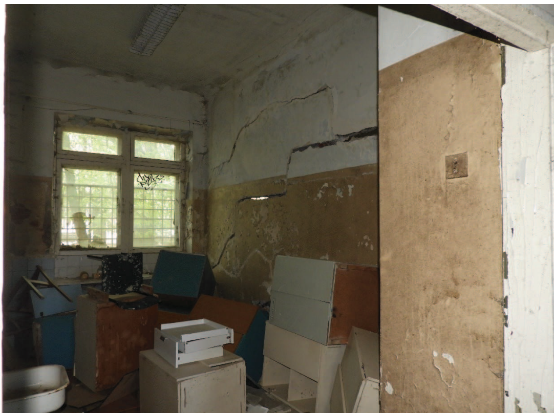
31. Интерьер. Западное помещение на первом этаже. Поперечные сквозные трещины.
