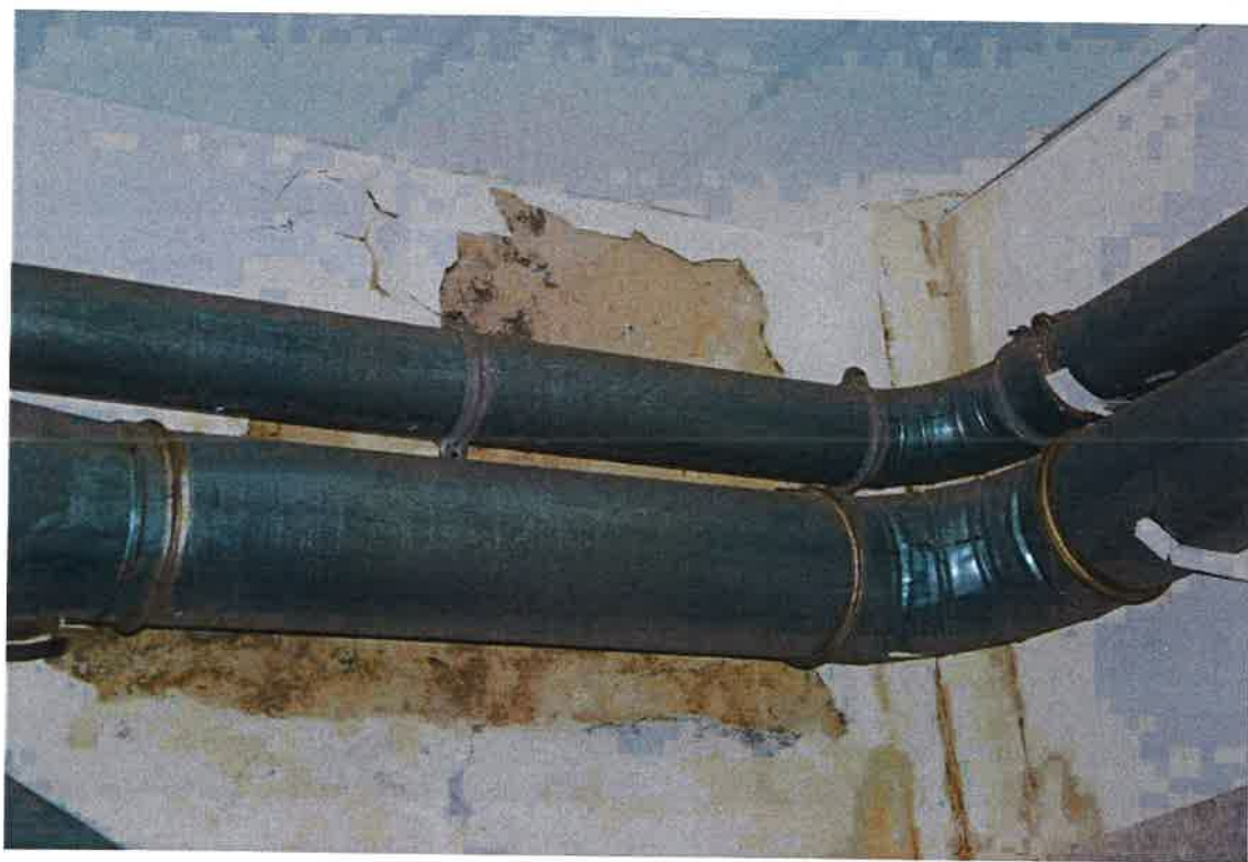
20. Пищеблок, интерьер. Участок утраты штукатурной облицовки на восточной стене.
