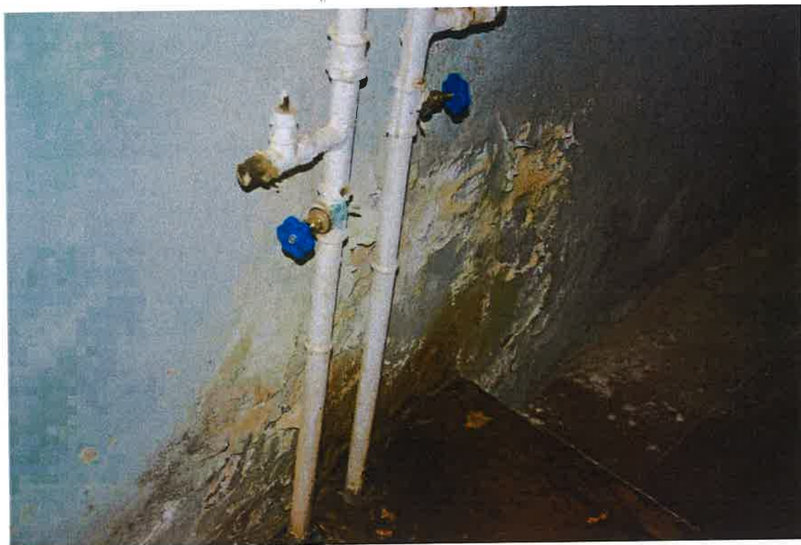
35. Подклет. Биопоражения у ввода коммуникаций.
