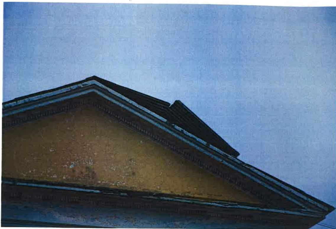
43. Аварийное состояние кровельного покрытия. Скат фронтона северного портика.
