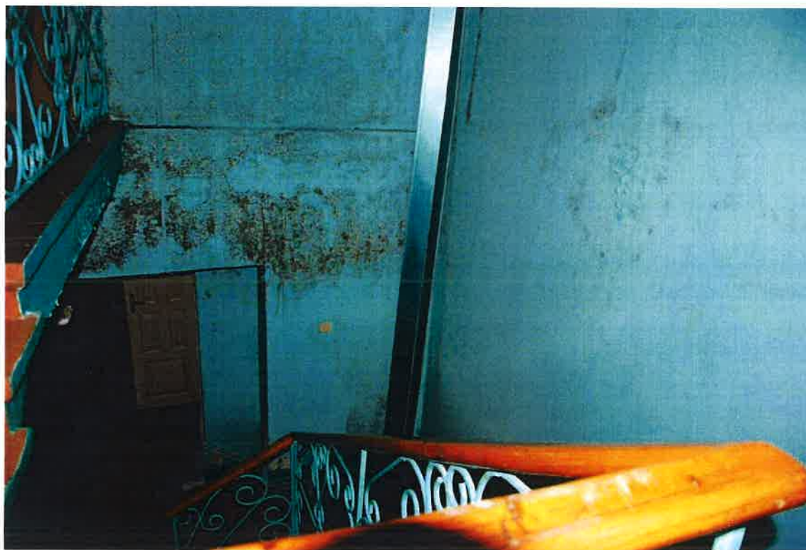
40. Биопоражение грибком стены лестничной клетки.
