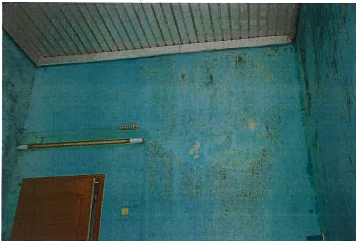
39. Стена лестничной клетки в восточной пристройке. Биопоражение грибком в зоне протечек.
