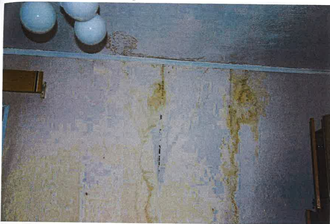
33. Помещение в восточном крыле второго этажа. Следы протечек.
