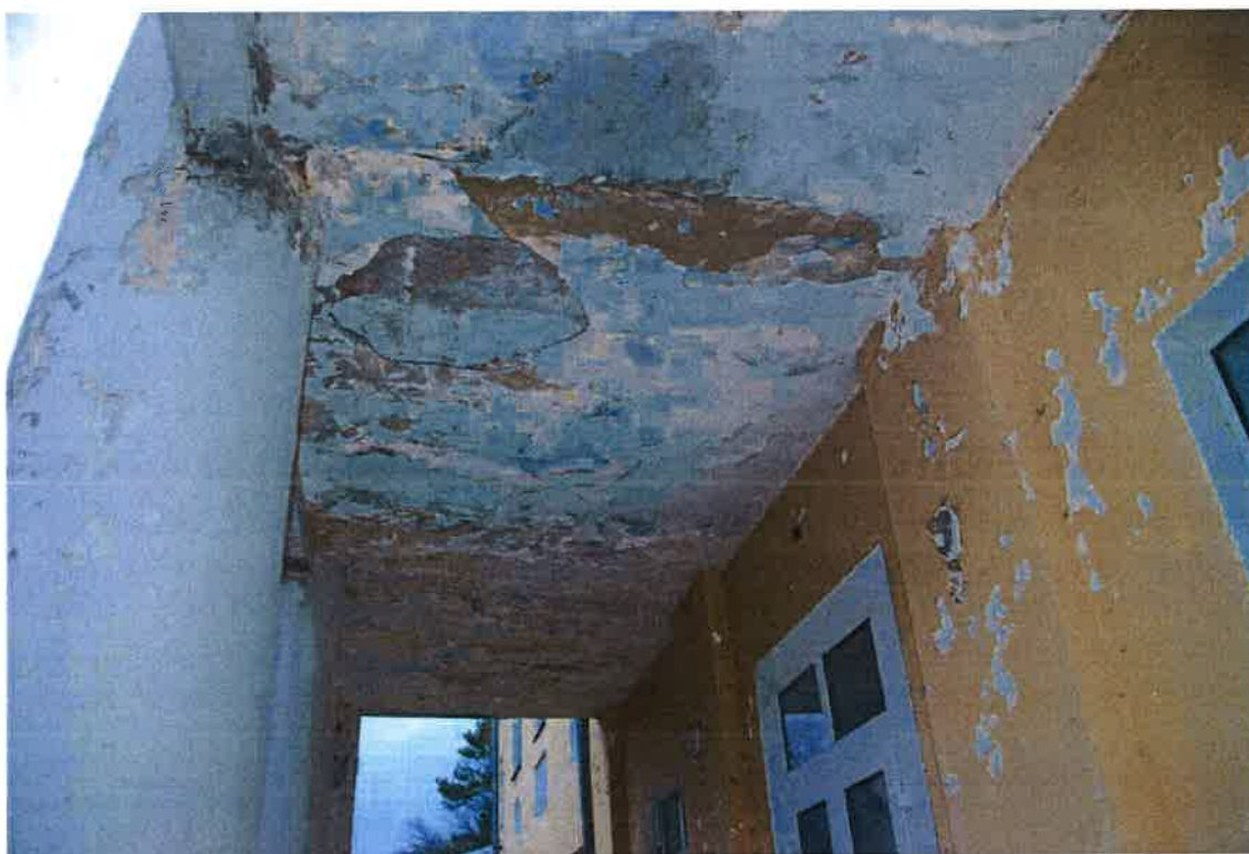
16. Нижний балкон портика. Вид на восток. Состояние перекрытия.
